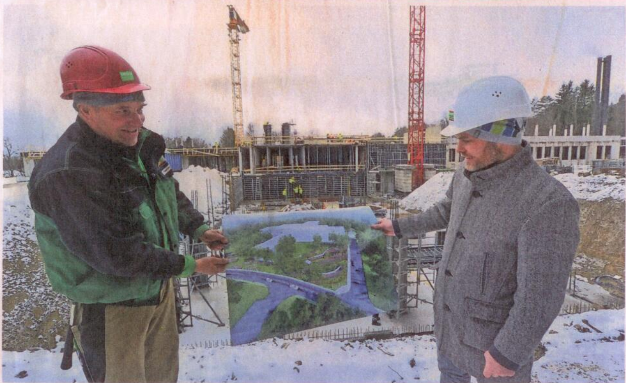
In Feldafing arbeiten Geschäftsführer Simon Machnik und Polier Wikterp Haseitl (re.) am Neubau des Benedictus-Krankenhauses.
